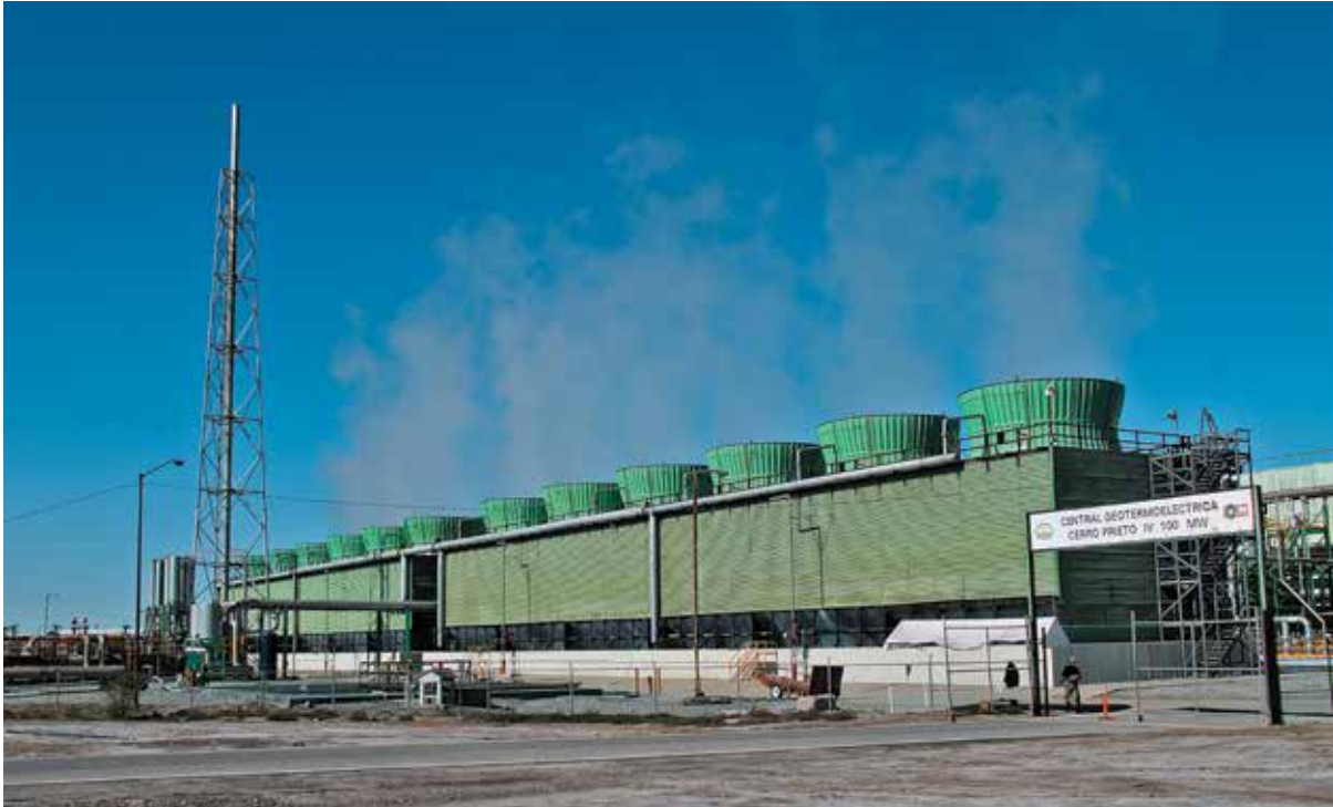
Figura 56 Planta geotérmica de Cerro Prieto, Baja California
