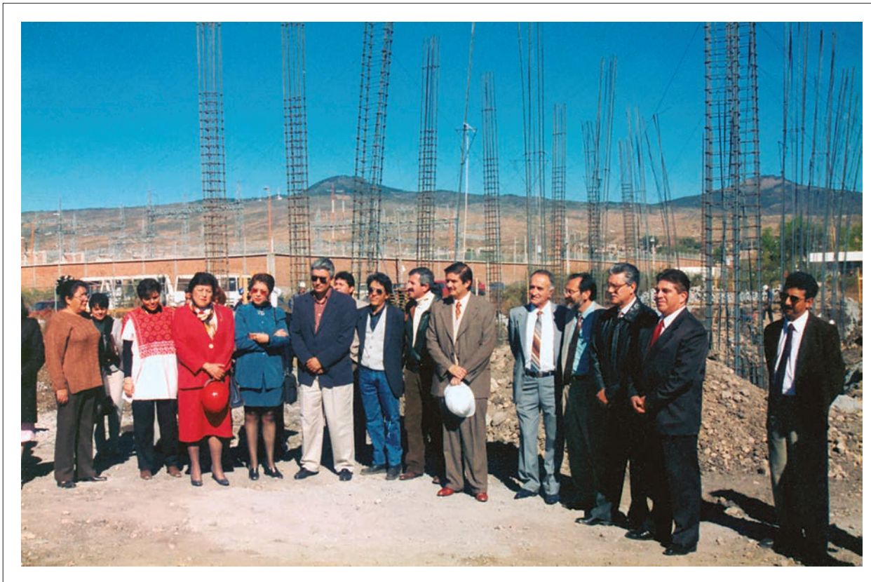
Construcción del primer edificio del Instituto de Investigaciones sobre Recursos Naturales, (AFJNG).
