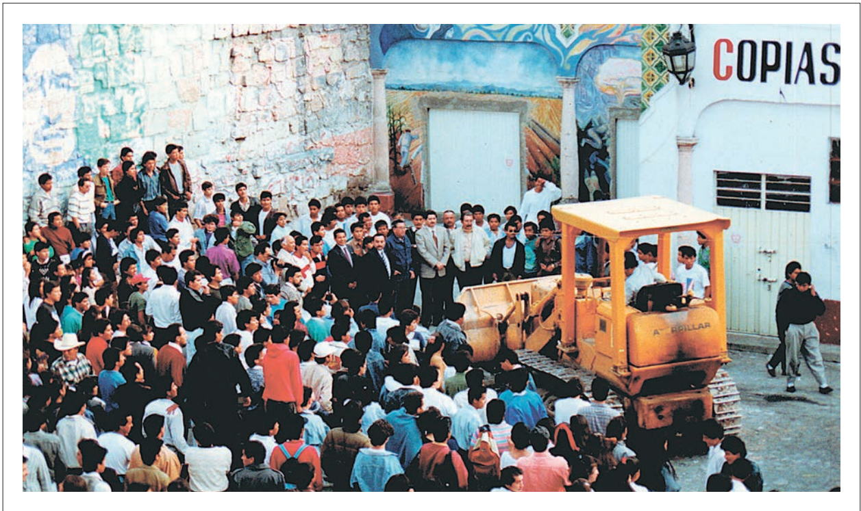
Inicio de los trabajos de construcción del Centro Cultural Universitario, (FOTO DE MARCO ANTONIO ARÉVALO).
