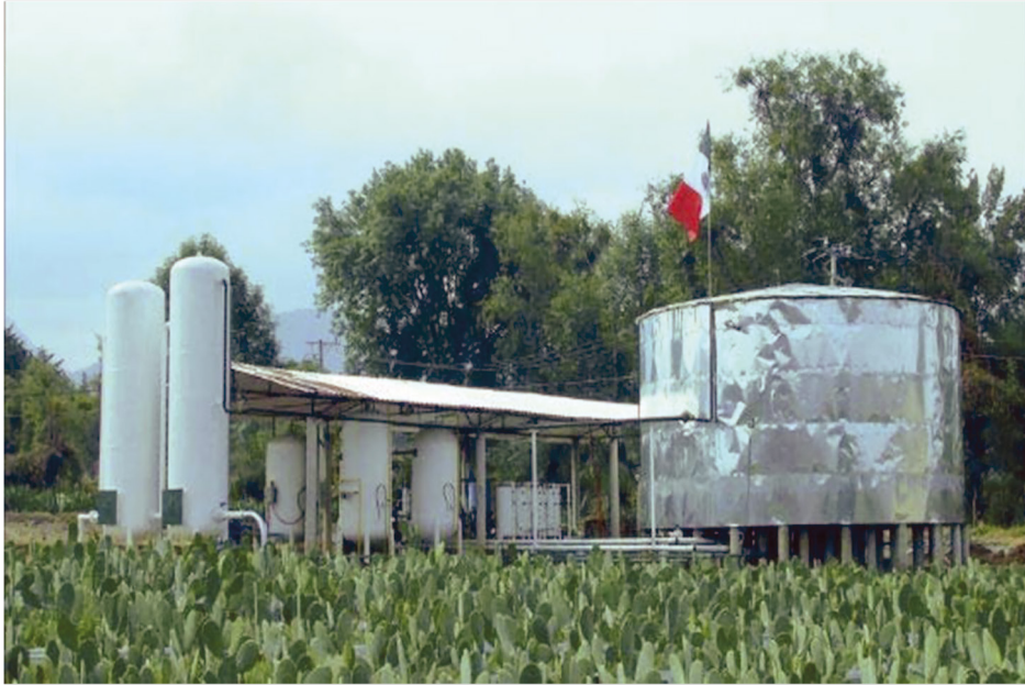
Imagen inicial de la planta, se aprecian tanques de almacenamiento, tanques de purificación, calentadores y el biodigestor Foto: Nopalimex
