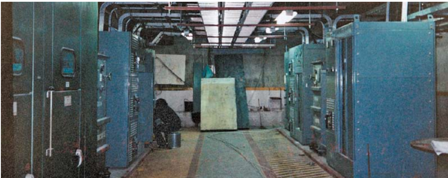
Sala de máquinas.
