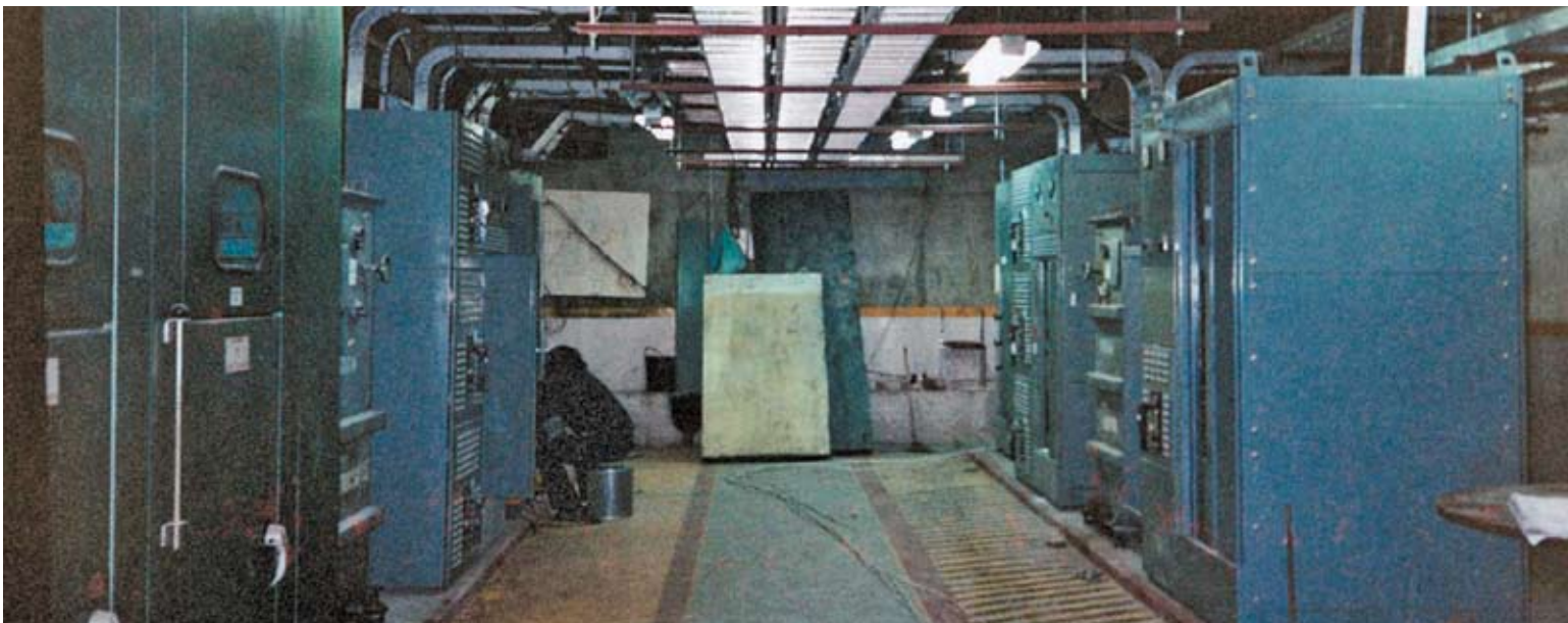
Sala de máquinas.
