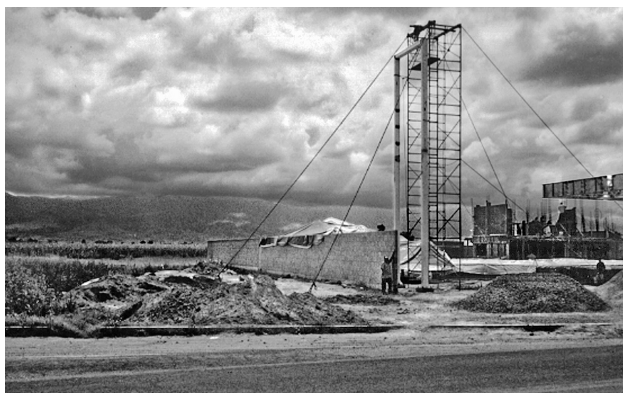
Construcción de una nueva gasolinera localizada en la carretera Chalco-Cuautla, sobre tierras de cultivo. Cabe señalar que entre 2002 y 2004 se autorizaron doce nuevas gasolineras en el municipio. Foto: Jaime Linares Zarco, 2004.
