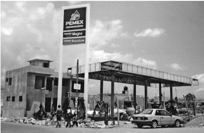
Construcción de una nueva gasolinería sobre la Avenida del Peñón al inicio de la Colonia Ciudad Alegre.
